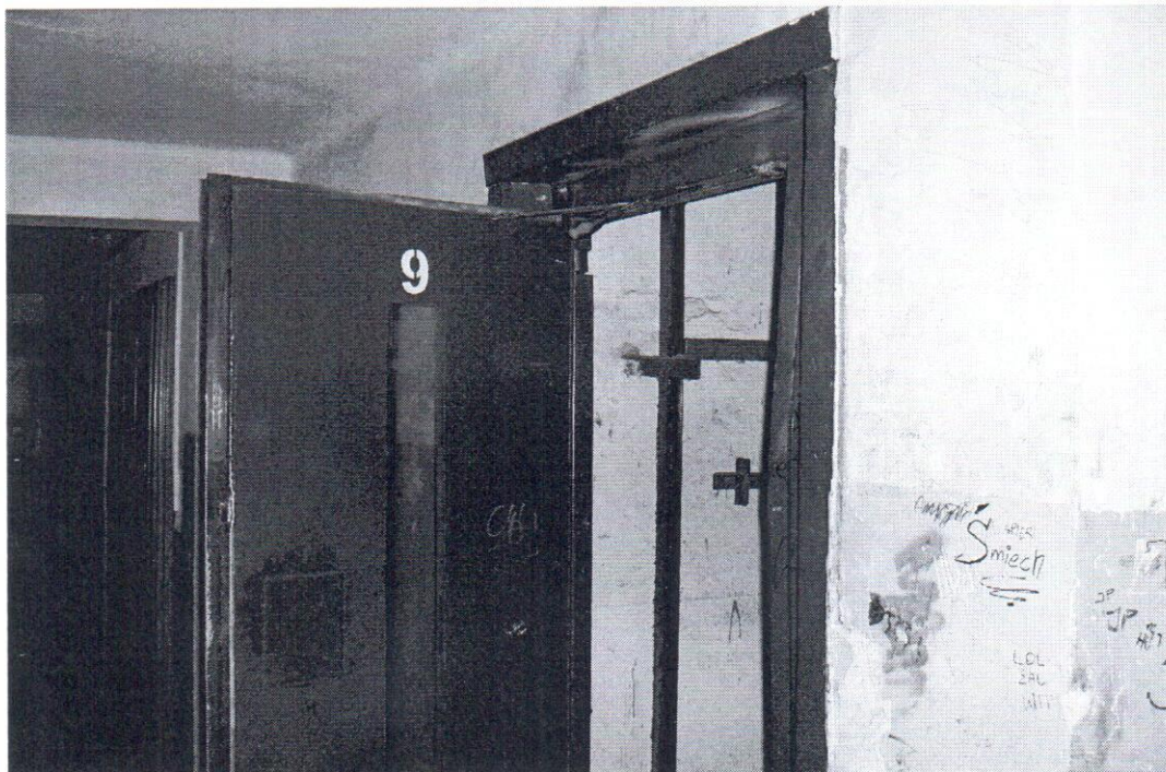
Fot.4. Uszkodzenia drzwi na 9 piętrze.
