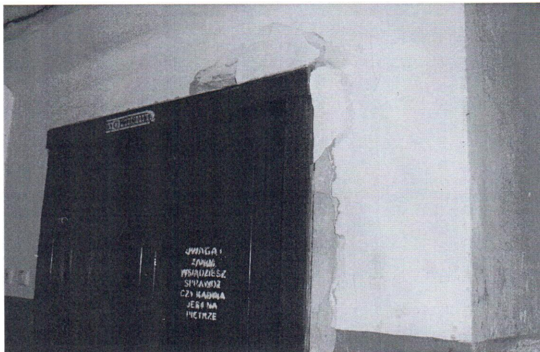
Fot.7. Uszkodzenia drzwi i tynku na 6 piętrze.
