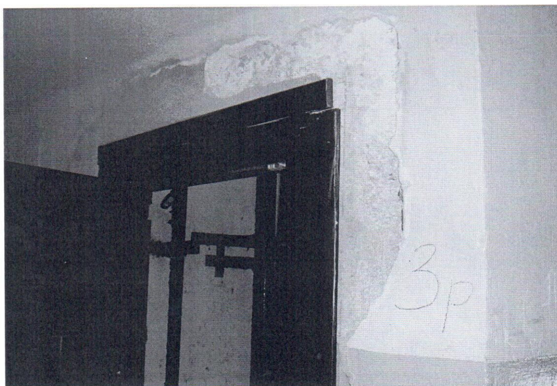
Fot.10. Uszkodzenia drzwi i tynku na 3 piętrze.
