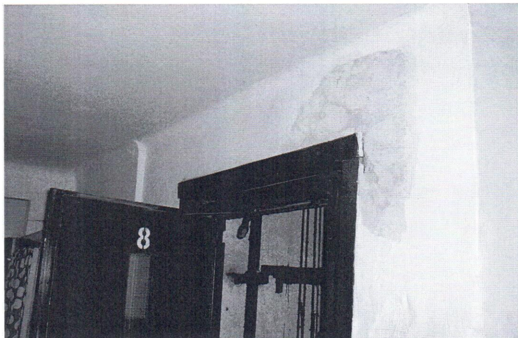
Fot.5. Uszkodzenia drzwi i tynku na 8 piętrze.
