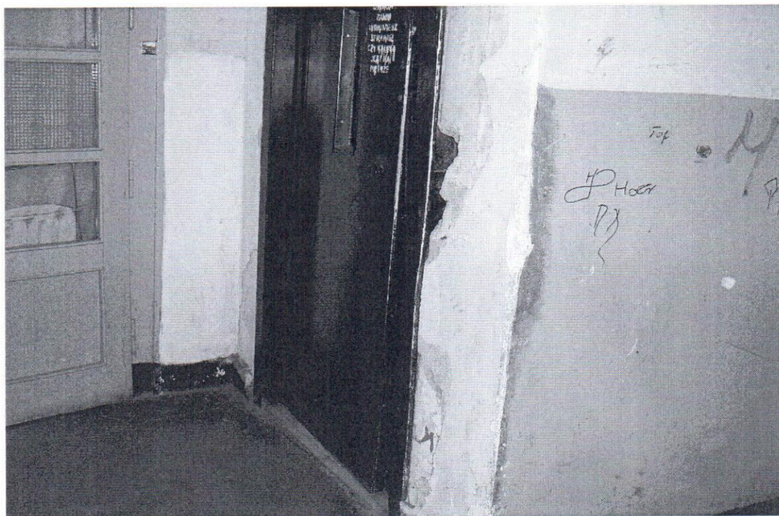
Fot.13. Uszkodzenia drzwi i tynku na parterze.
