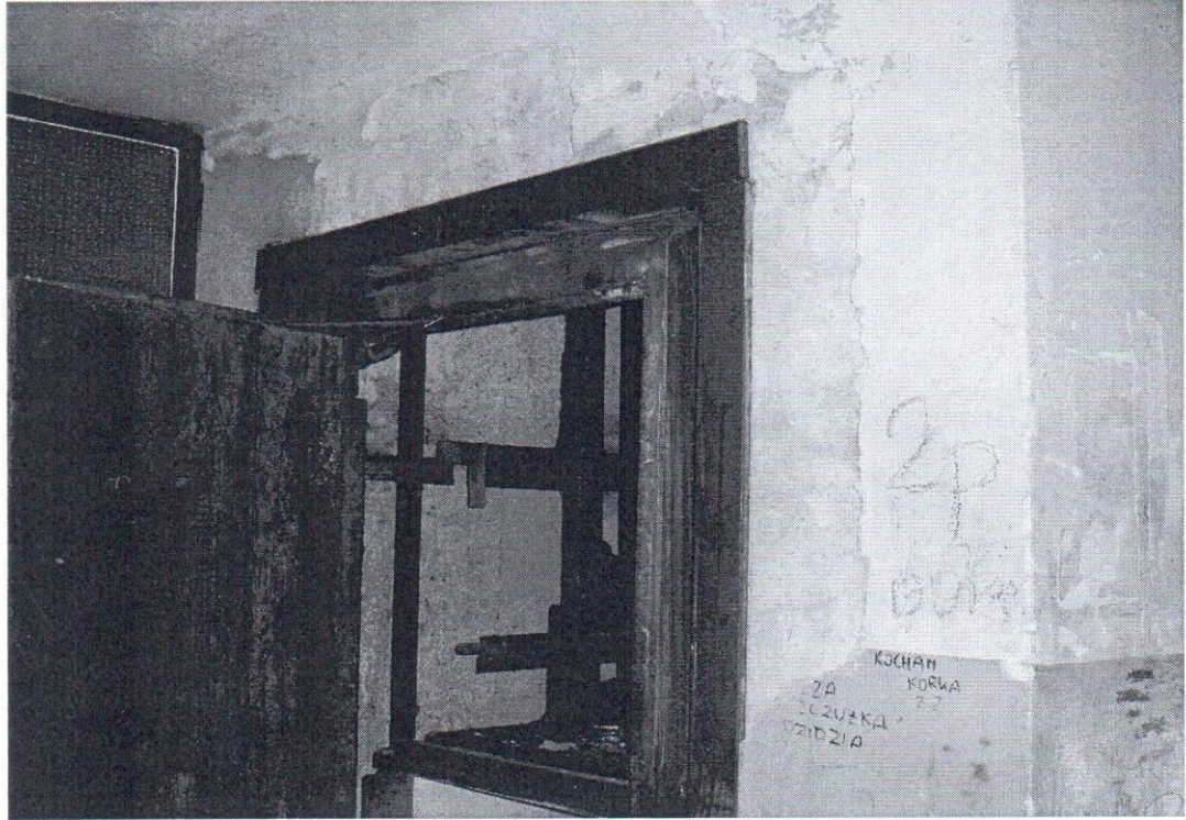
Fot.11. Uszkodzenia drzwi i tynku na 2 piętrze.
