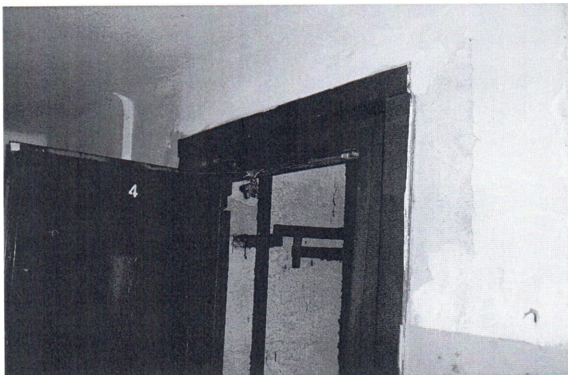
Fot.9. Uszkodzenia drzwi i tynku na 4 piętrze.
