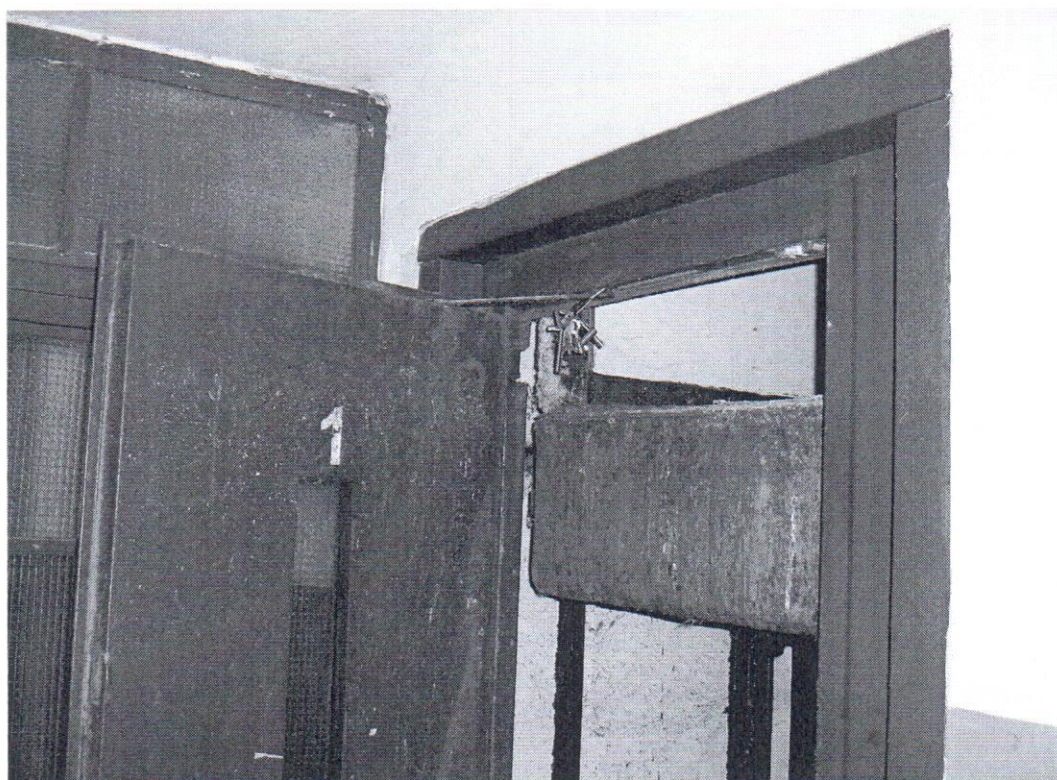
Fot.11. Uszkodzenia drzwi i tynku na 1 piętrze.
