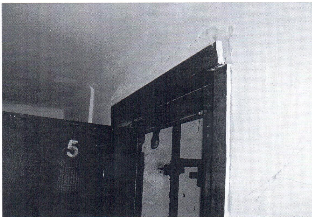
Fot.8. Uszkodzenia drzwi i tynku na 5 piętrze.
